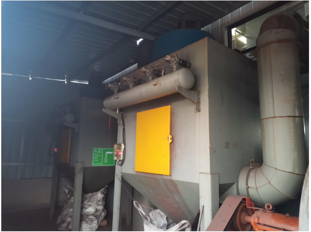
抛丸和焊接废气处理设施
