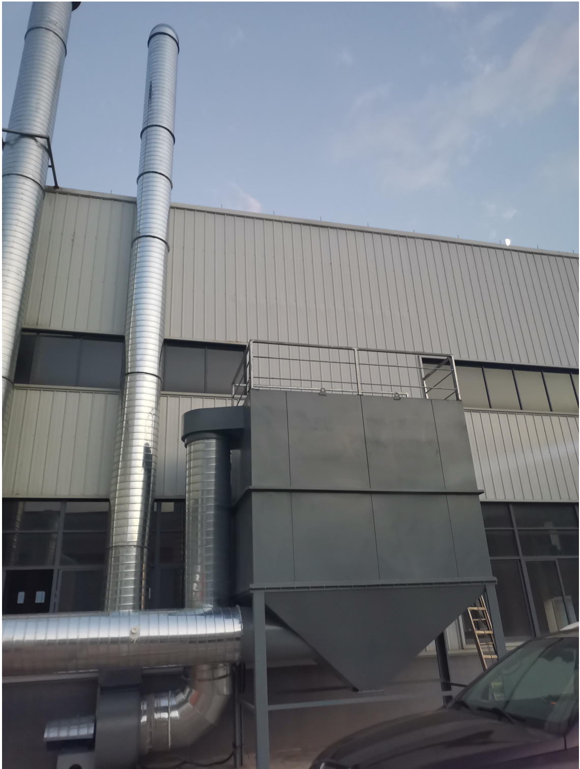
打磨废气处理及排气筒设施照片（左侧为打磨废气排气筒，右侧为喷漆废气排气筒）
