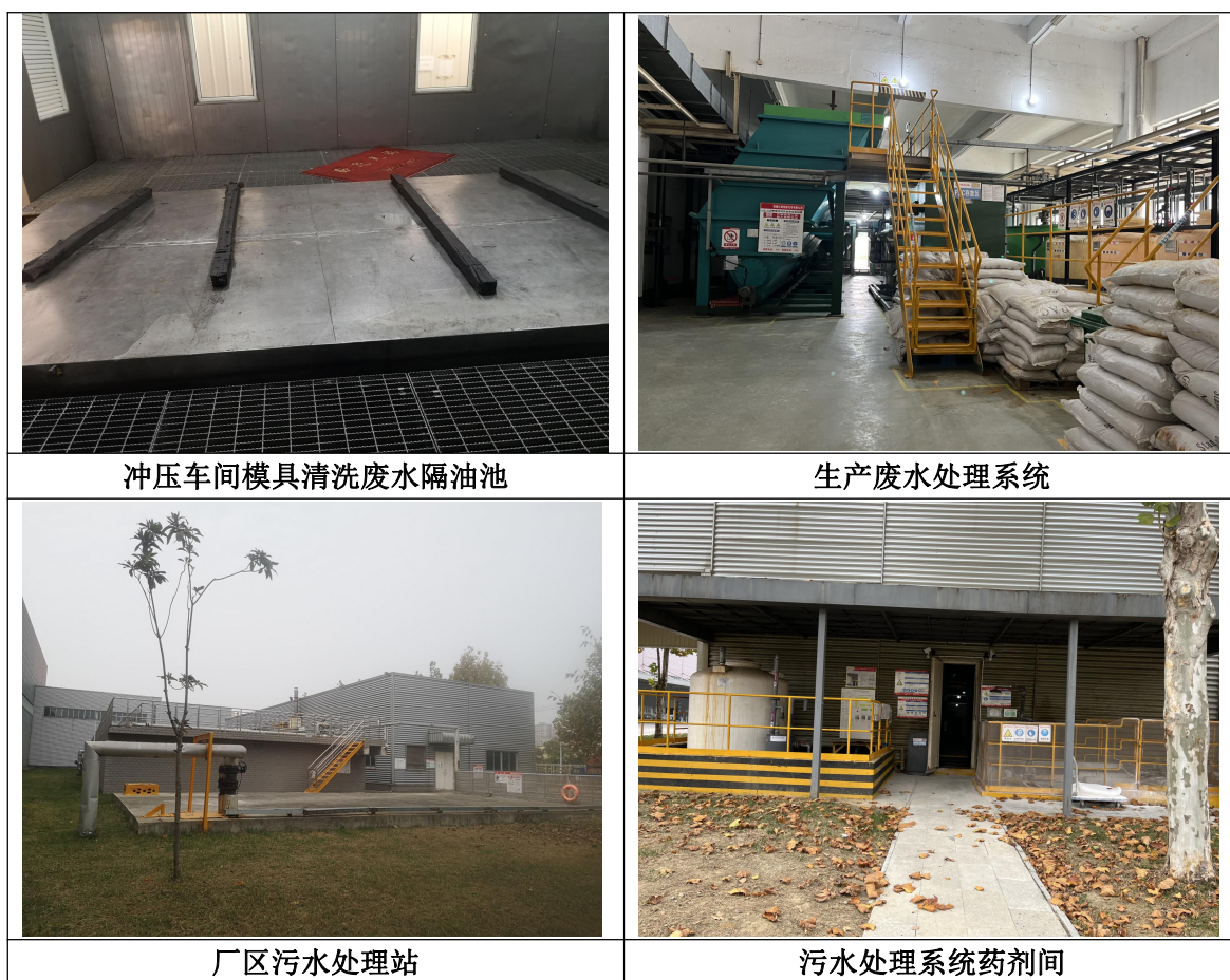
图4.1-3 废水处理措施照片
