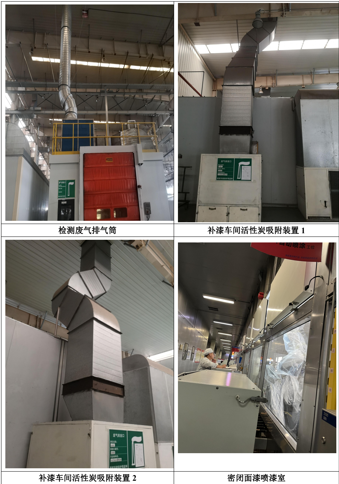
图 4.1-4 废气治理措施照片
