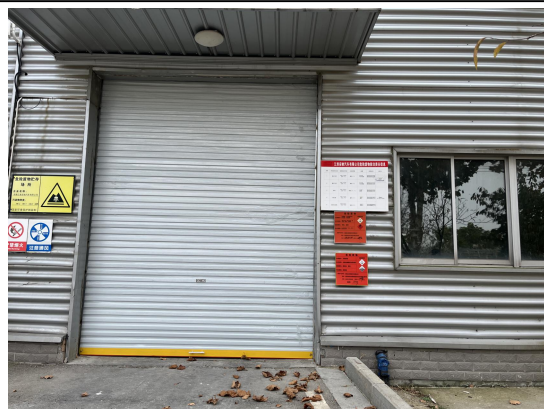
危废暂存间（标识、大门）
