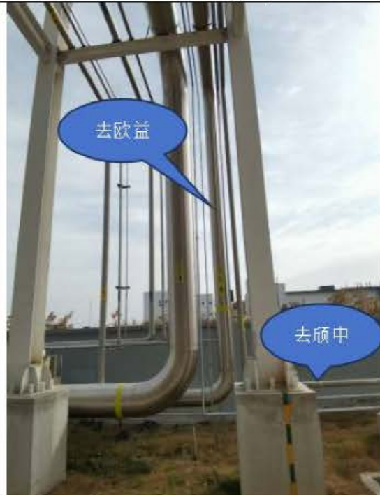
厂内氮气管线
